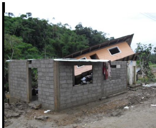
Foto No 7 Afectación comunidad Ongota Información: pública 2010
