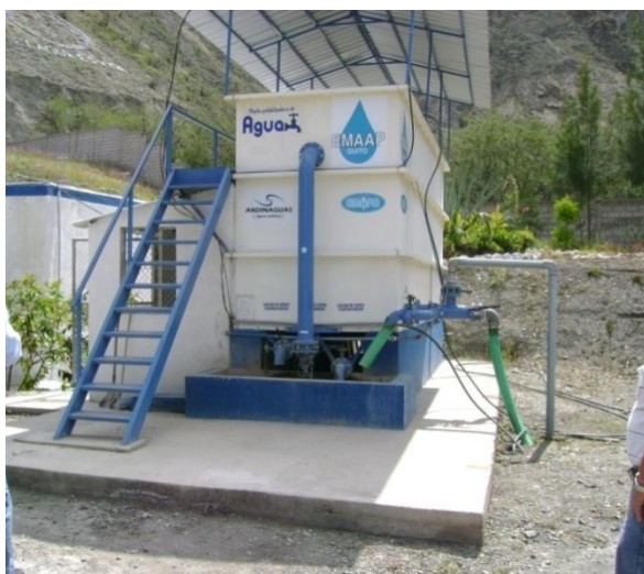
Foto N° 13 Planta de tratamiento de Carpuela
